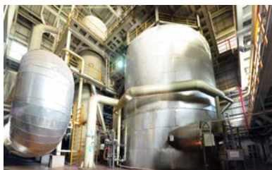
▲ 不锈钢废混酸再生
