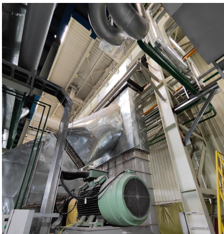
常化炉排气筒
