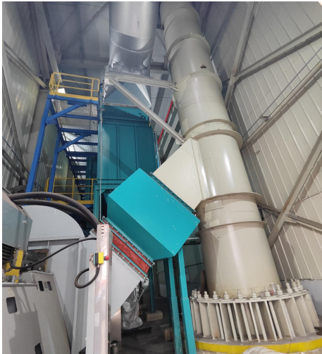
常化酸洗线抛丸除尘器及排气筒
