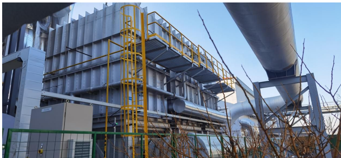
图 4-5 RTO 焚烧炉设施
