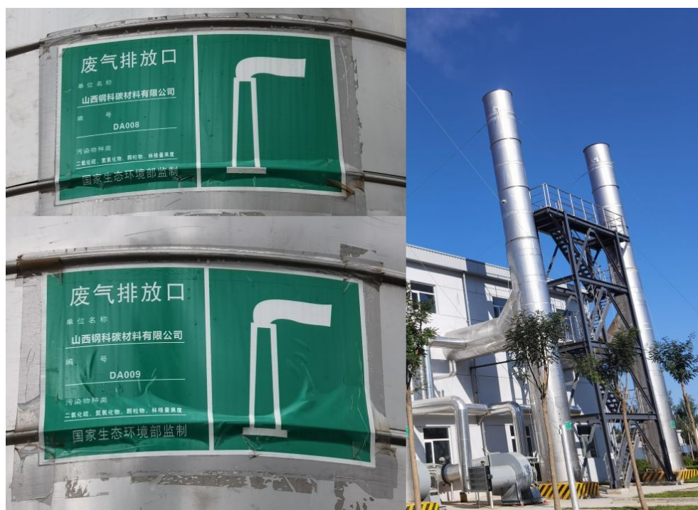
图 4-12 DA008、DA009 排气筒及图形标识图
