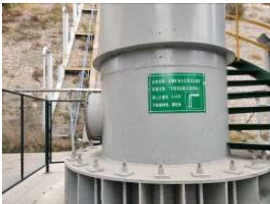
转运站除尘器排放口
