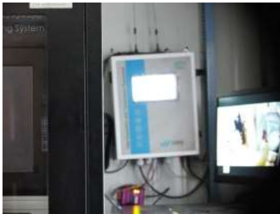
选矿区燃煤锅炉在线监测设备
