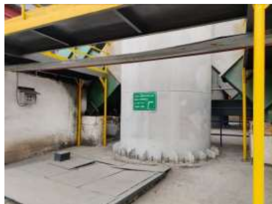
筛分除尘器排气筒
