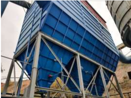
西侧磨选除尘器
