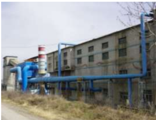
中碎除尘器及排气筒
