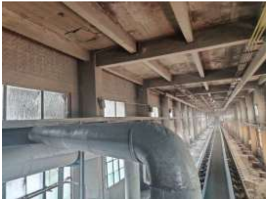
胶带机及移动收尘管道
