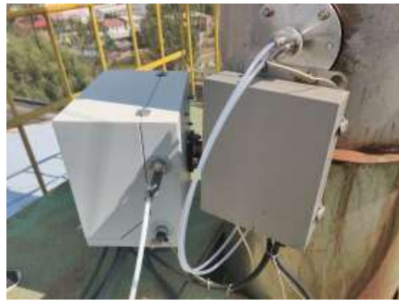
生活区燃气锅炉在线监测设备
