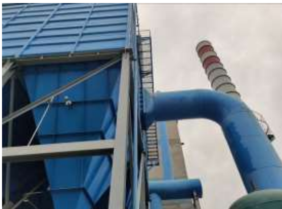
细碎车间除尘器
