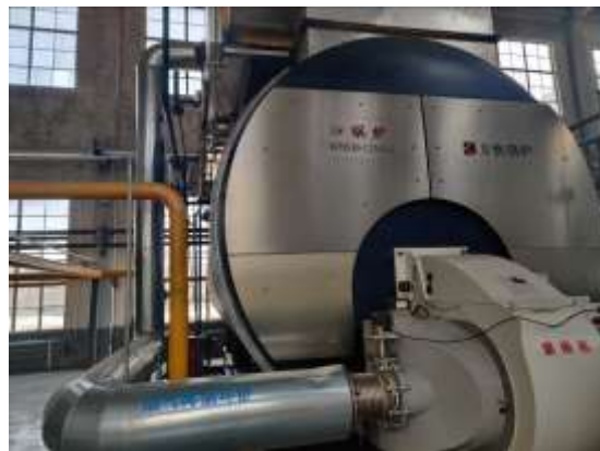
燃烧机及烟气循环管道
