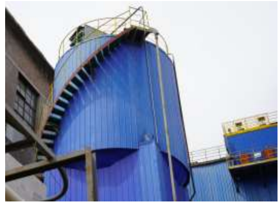
喷氨(脱硝)系统
