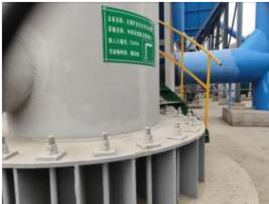
中碎除尘器排污口规范化设置
