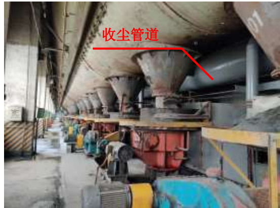
圆盘给料机及收尘管道
