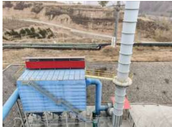
东侧磨选除尘器及排气筒
