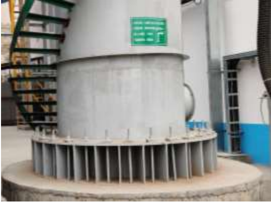
除尘器排放口规范化设置
