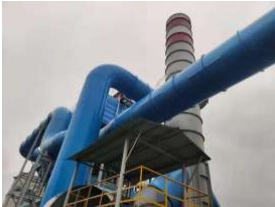
除尘器及排气筒
