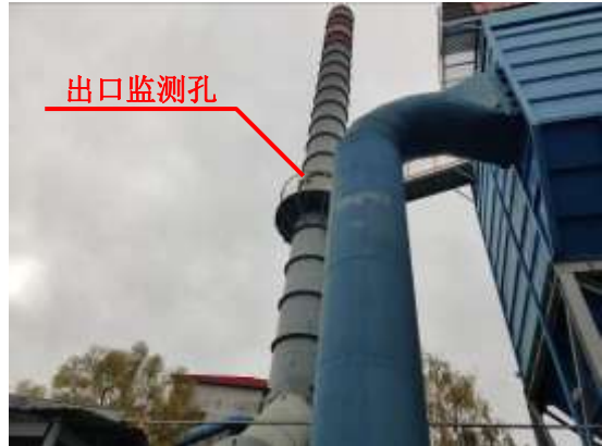
西侧排气筒及监测孔
