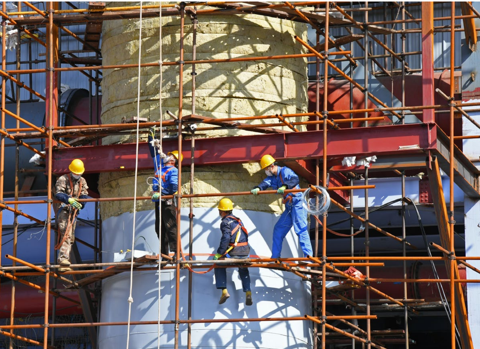
烧结烟气超低排放改造
