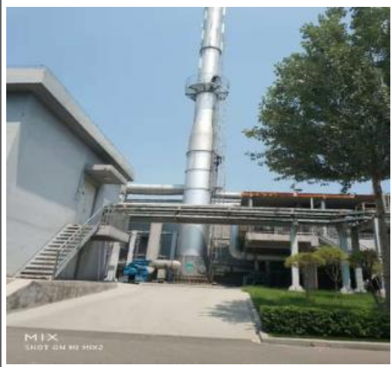
焚烧炉排气筒
