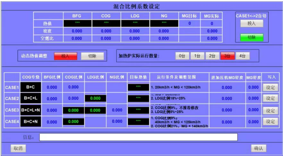
煤气站控制系统界面
