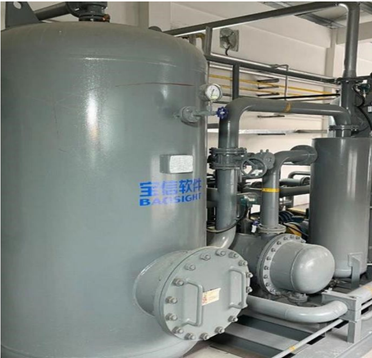
氢气回收罩式炉机组
